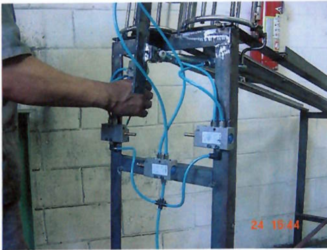
Fig. 23 – Detalhe da parte pneumática (válvulas).
